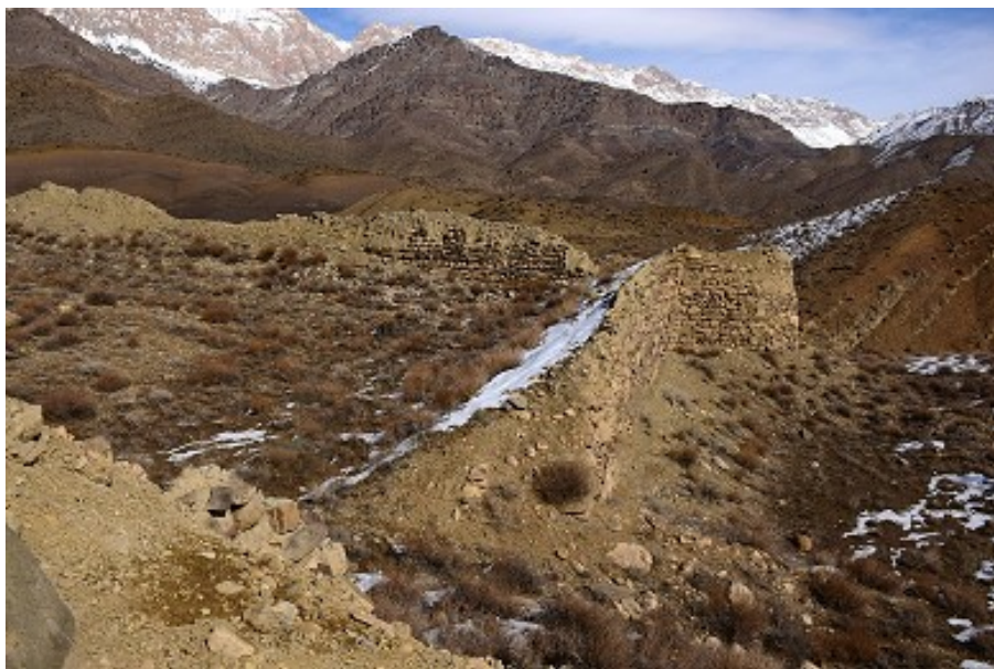
عکس ۵- نمایی از خندق اطراف قلعه در جبهه جنوبی برای رعایت اصل پدافندی مقاوم‌سازی (مأخذ: نگارندگان)
